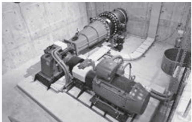
▲水海小水力発電所の発電部(3月4日から発電開始)
